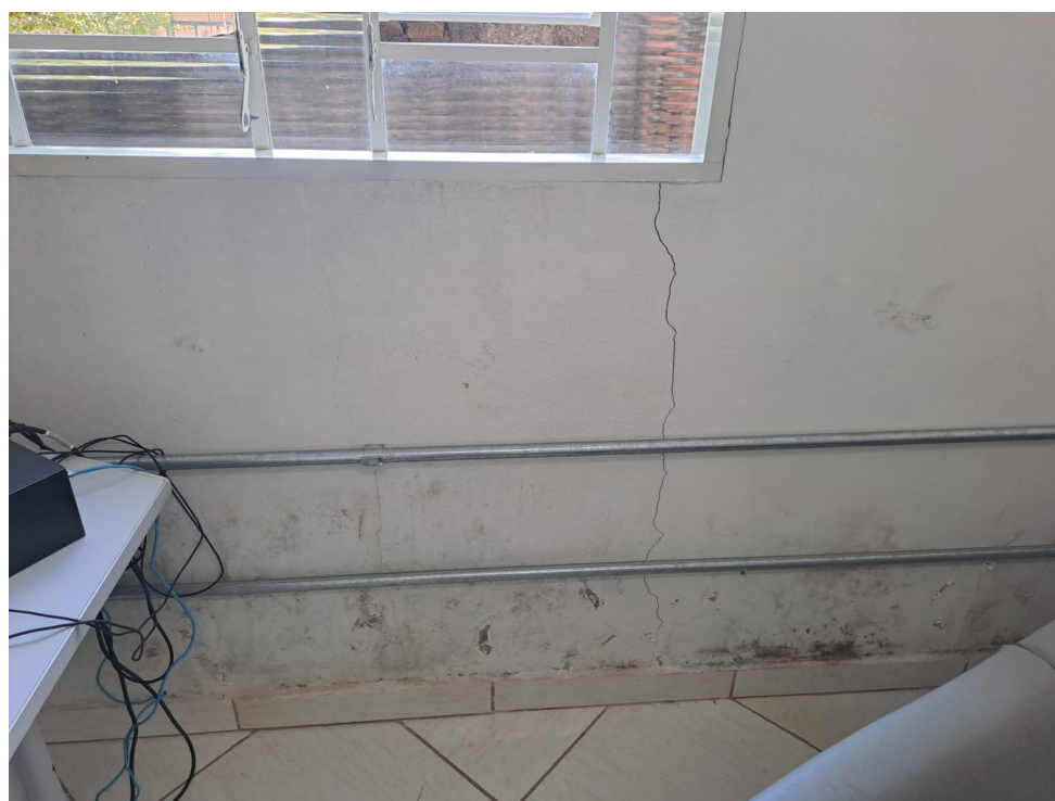
Sala do Secretário - Trincas e bolor na parede
