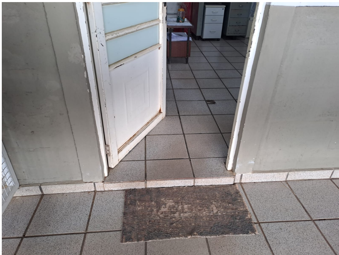
Entrada Sala administrativo sem acessibilidade
