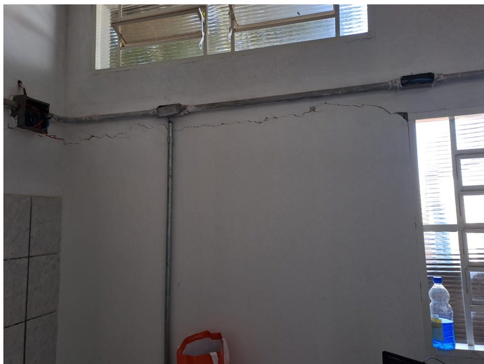
Sala do Secretário - Trincas na parede
