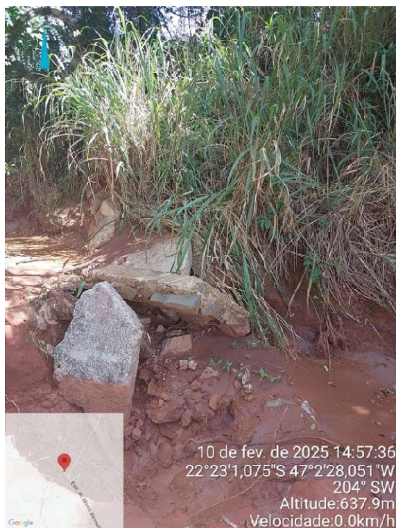
Figura 7: MMR 050 – setor 1 – rolamento de entulho e danos a estruturas de drenagem devido às fortes chuvas
