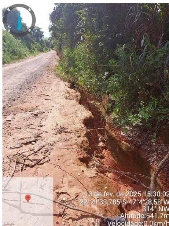
Figura 15: MMR 050 – setor 2 – sulcos de erosão nas laterais da pista
