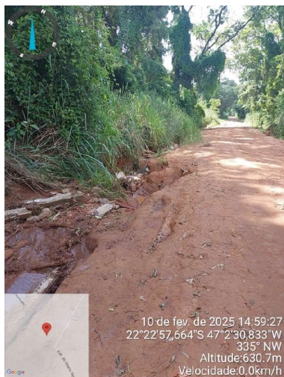
Figura 8: MMR 050 – setor 1 – sulcos laterais e rolamento de entulho danificando a plataforma da estrada
