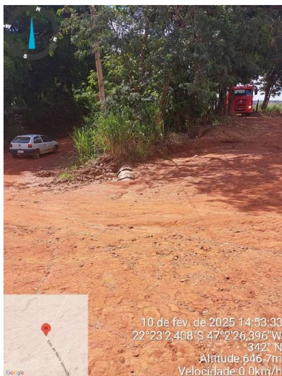
Figura 5: MMR 050 – setor 1 – erosões laminares abaixam o nível do greide e prejudicam os acessos
