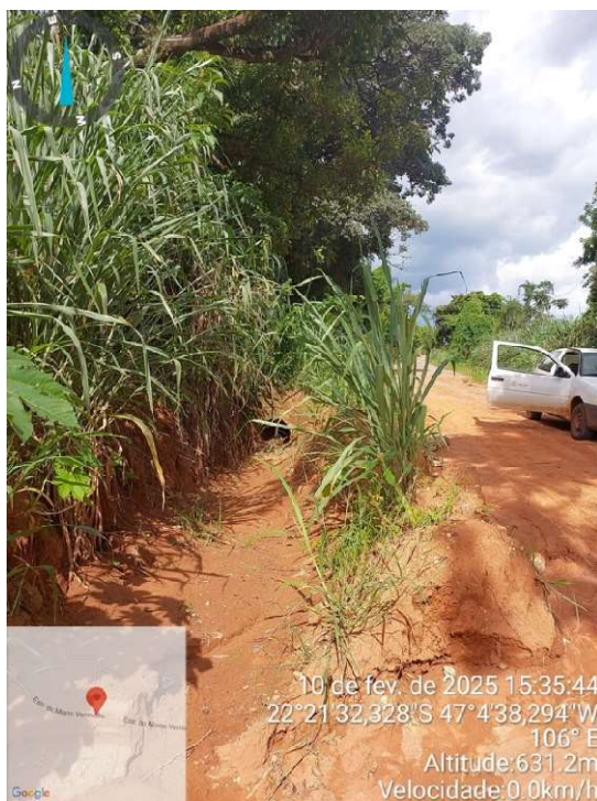
Figura 16: MMR 050 – setor 2 – assoreamento em canaletas laterais
