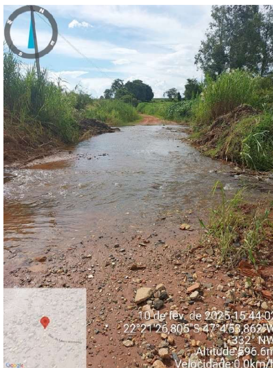
Figura 19: MMR 050 – setor 2 –divisa com o município de Conchal com tráfego impedido pela inundação do Córrego
