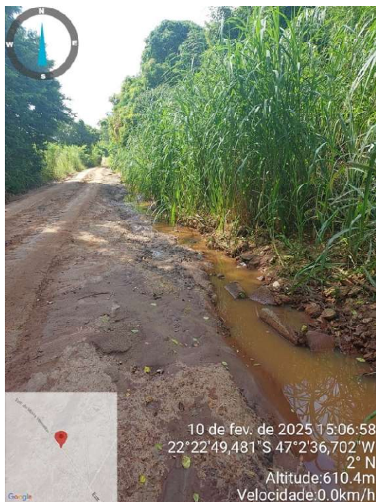
Figura 10: MMR 050 – setor 1 – minas d` água escoam pelos sulcos laterais
