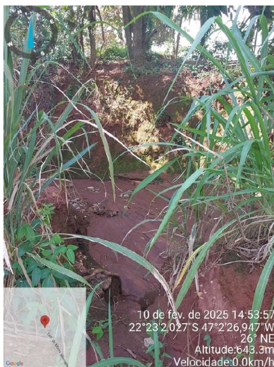
Figura 6: MMR 050 – setor 1 – assoreamento de caixas e valas de drenagem
