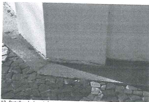
12. Detalhe da área inferior do basamento, com fissuras que permitem infiltrações de umidade nas fundações do Coreto.
