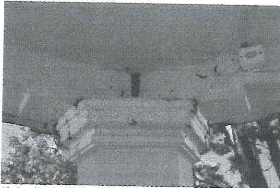
10. Detalhe da área superior do pilar leste, com instalações elétricas aparentes.
