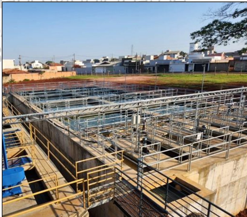
Figura 34 - Floculadores e decantadores da ampliação da estação
