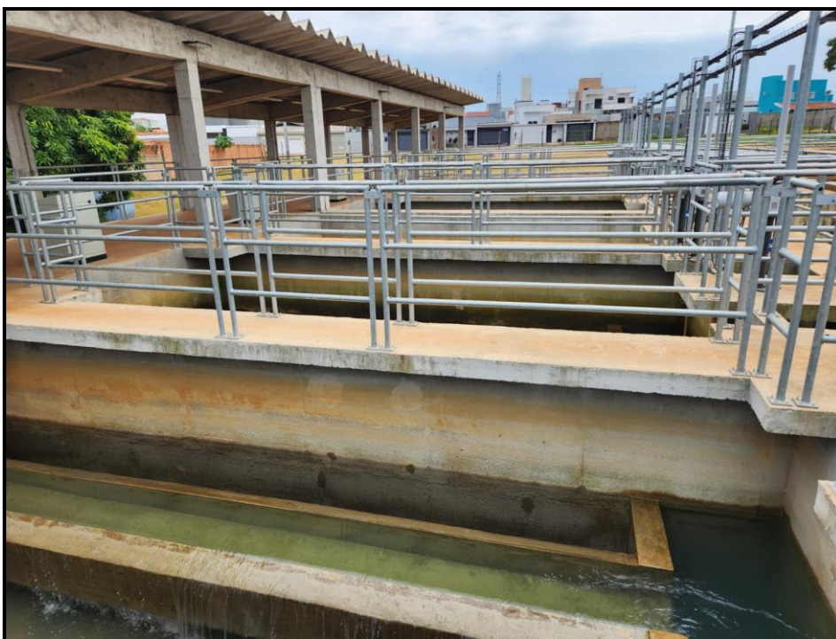
Figura 36 - Filtros da ampliação da estação
