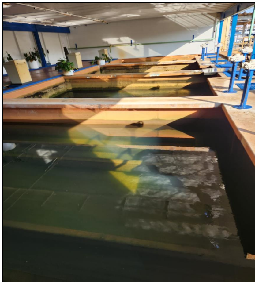
Figura 35 - Filtros da estação antiga
