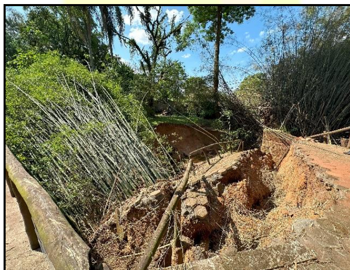
Figura 138 - Rompimento no vertedor do Córrego Bela Vista
