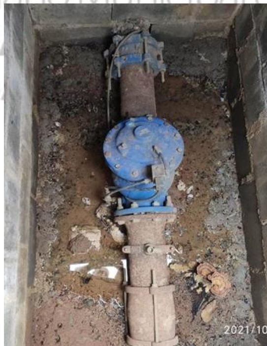
Figura 83 - Válvula de controle de nível
