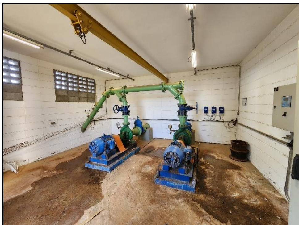
Figura 71 - Barrilete e conjuntos motor bomba
