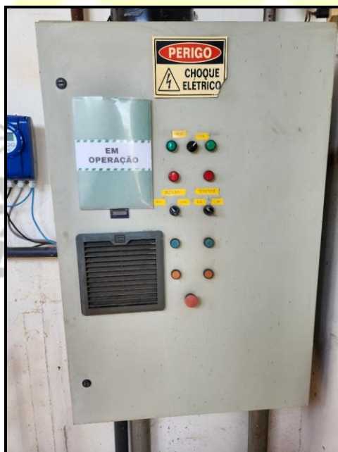
Figura 68 - Painel elétrico da estação elevatória
