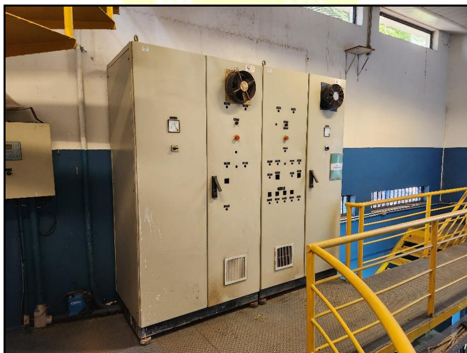
Figura 64 - Painel elétrico da estação elevatória
