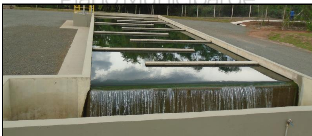
Figura 103 - Câmara de cloração
