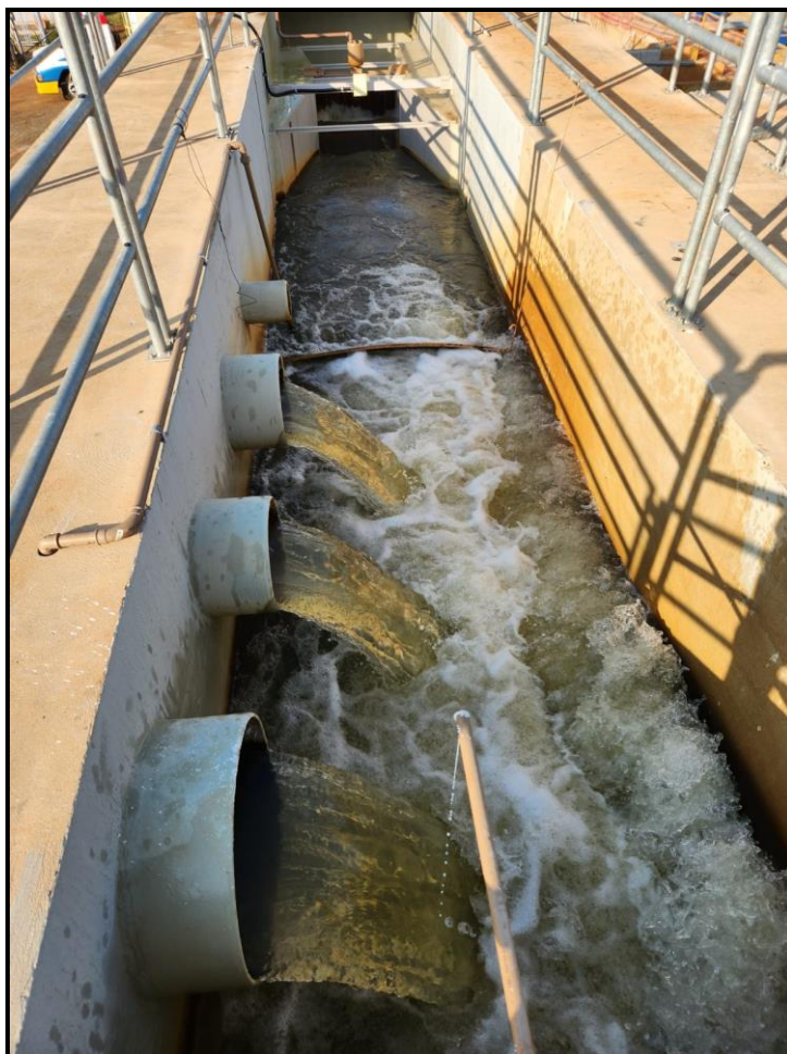
Figura 32 - Mistura Rápida - Calha Parshall na chegada da ETA
