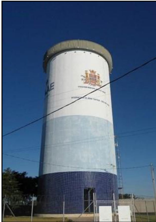
Figura 58 - Reservatório do Parque Real
