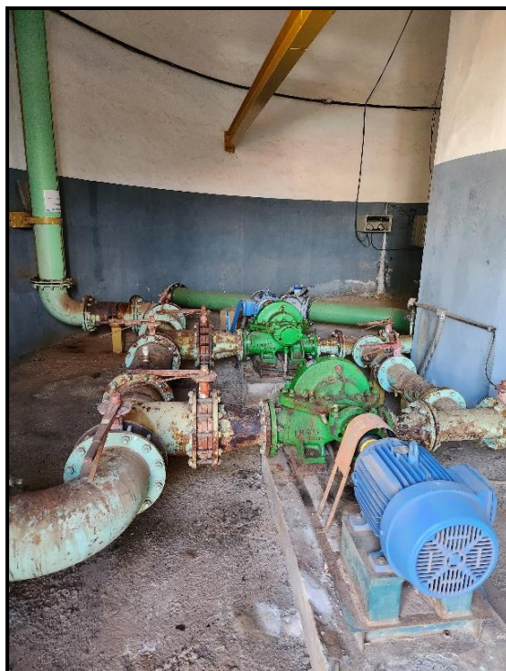
Figura 59 - Barrilete e conjuntos motor bomba
