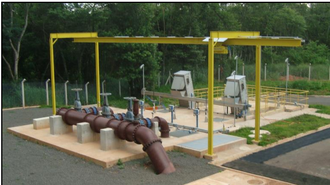
Figura 99 - Estação elevatória de esgotos da ETE
