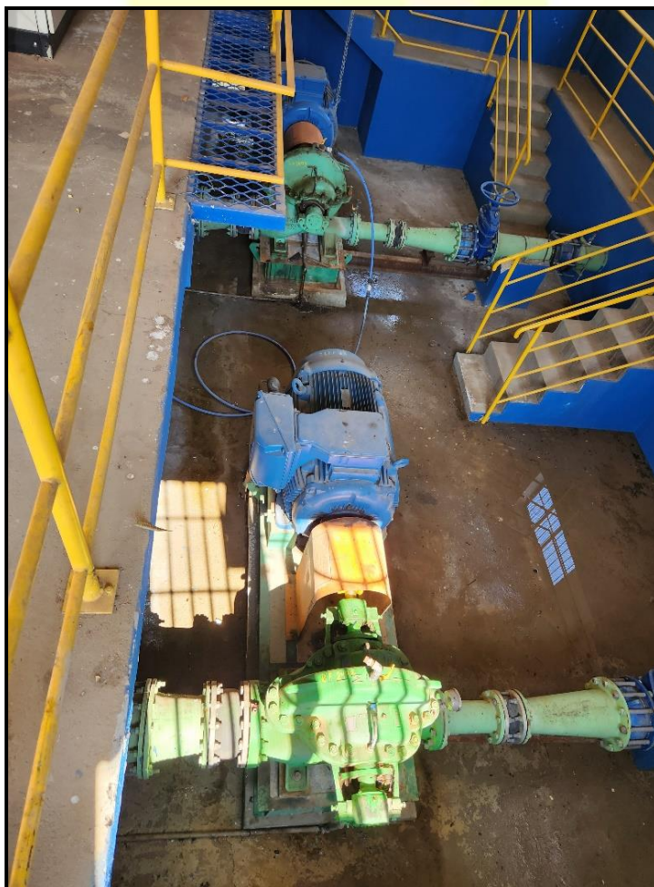
Figura 93 - Conjuntos Motor-Bomba do Zona Sul
