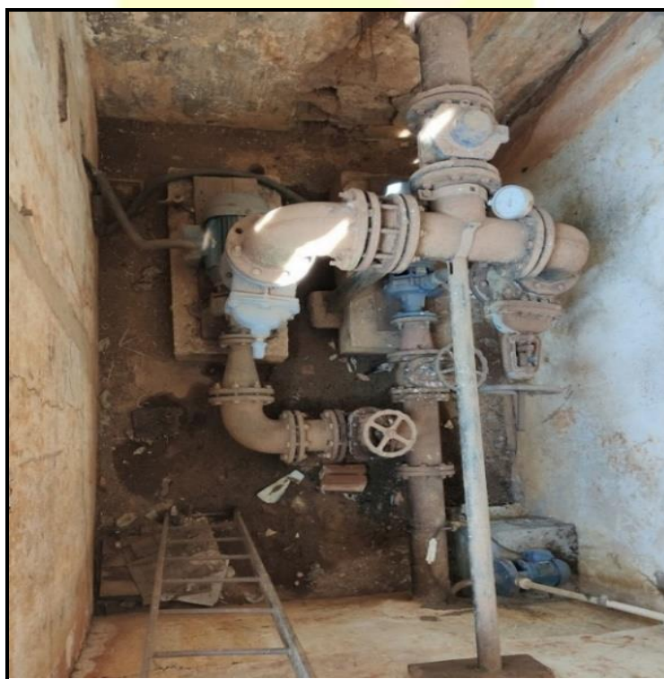
Figura 49 - Vista das instalações do Booster ETA I
