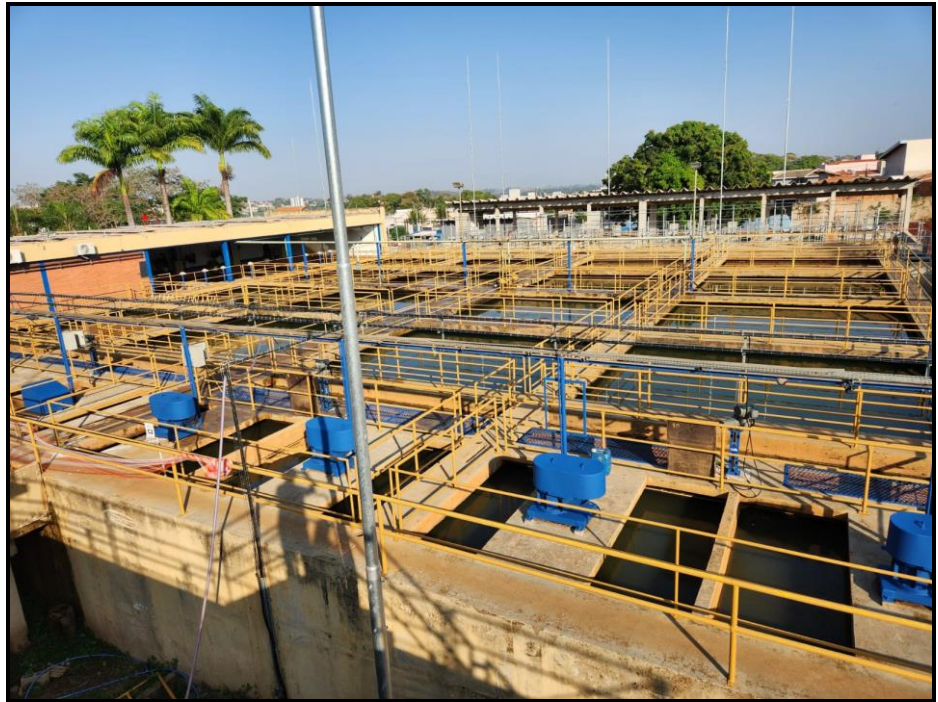
Figura 33 - Floculadores e decantadores da estação antiga
