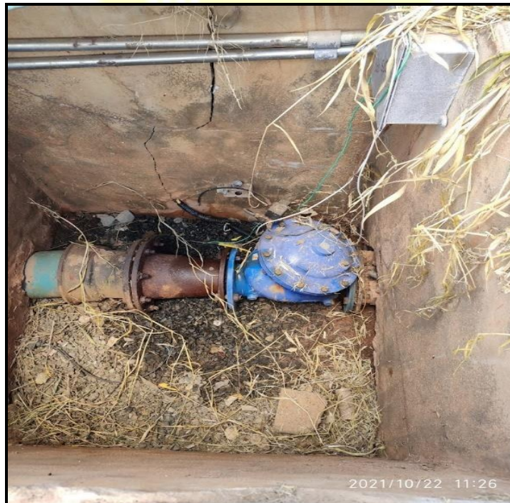
Figura 81 - Válvula de controle de nível
