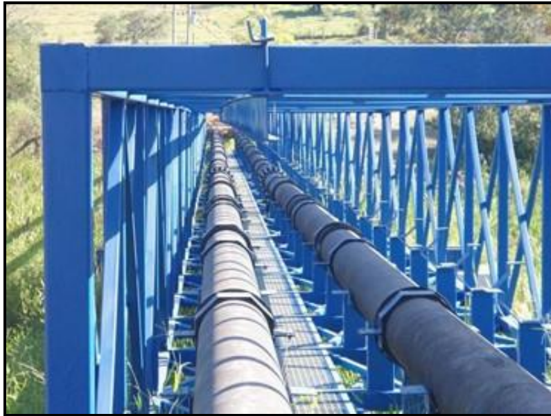
Figura 26 - Travessia das adutoras
