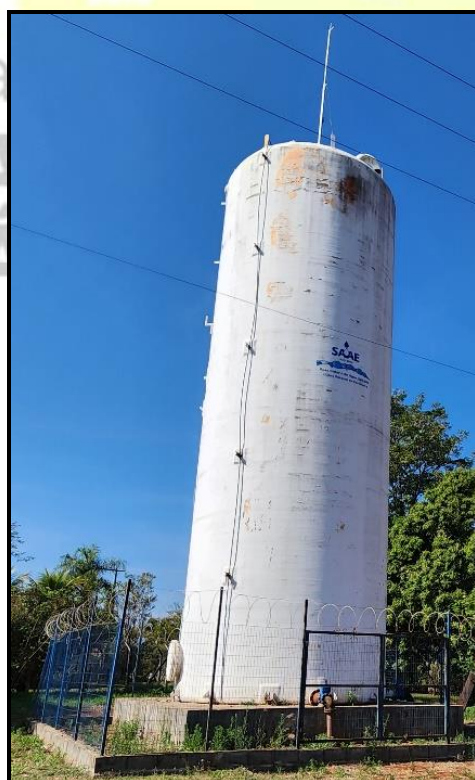
Figura 88 - Reservatório Chácaras Paraiso da Cachoeira
