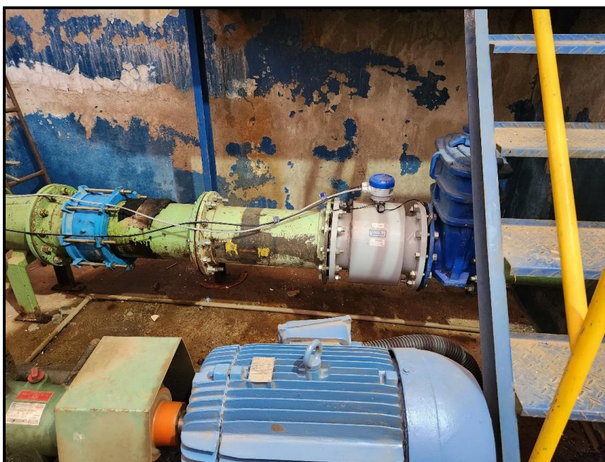
Figura 67 - Barrilete e conjuntos motor bomba
