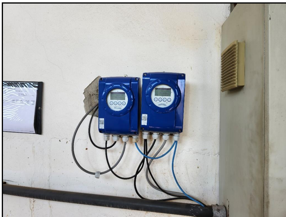
Figura 69 - Painel de telemetria da estação elevatória
