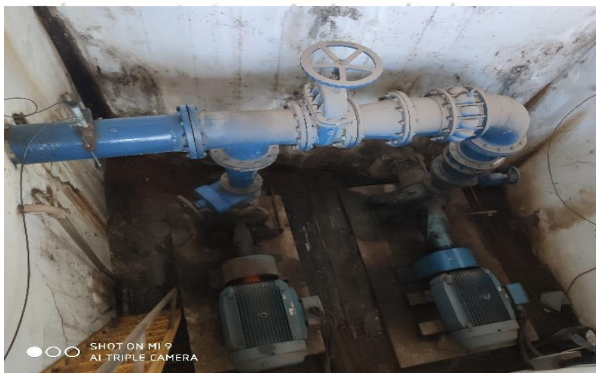
Figura 52 - Barrilete e bombas da estação elevatória da Sede
