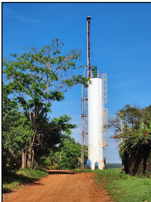
Figura 23 - Chaminé de equilíbrio de pressão - Stand Pipe
