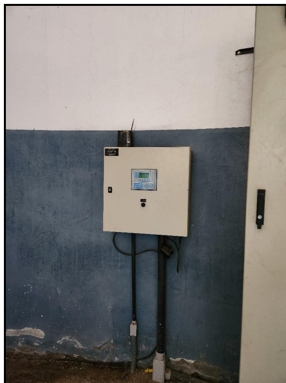
Figura 61 - Painel de telemetria da estação elevatória
