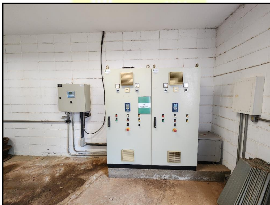
Figura 72 - Painel elétrico da estação elevatória
