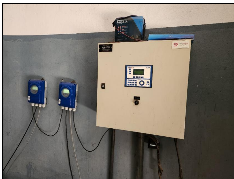
Figura 57 - Painel de telemetria da estação elevatória
