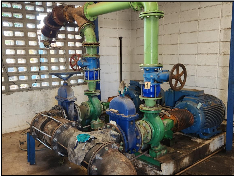
Figura 90 - Conjuntos Motor-Bomba do Booster TG
