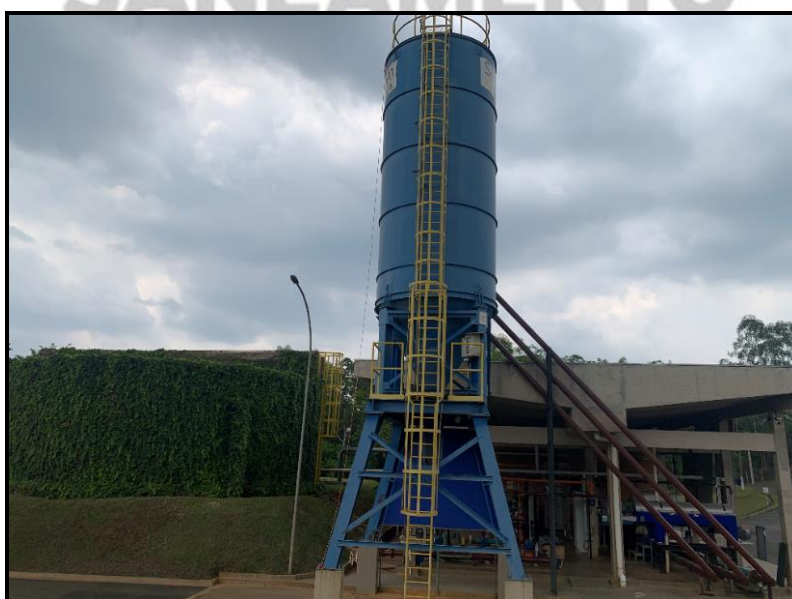
Figura 105 - Sistema de desidratação de lodos
