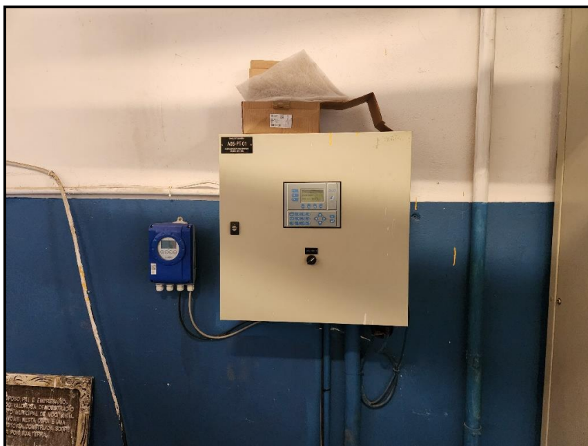
Figura 65 - Painel de telemetria da estação elevatória
