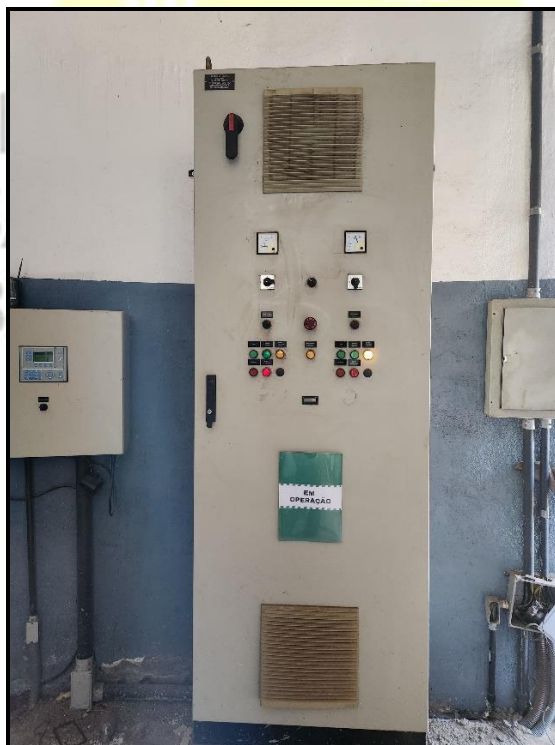
Figura 60 - Painel elétrico da estação elevatória
