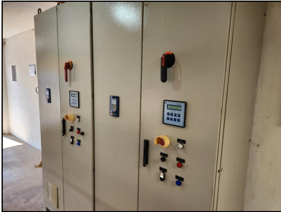
Figura 94 - Painel elétrico do Zona Sul
