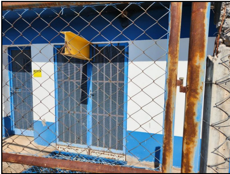
Figura 92 - Booster Zona Sul
