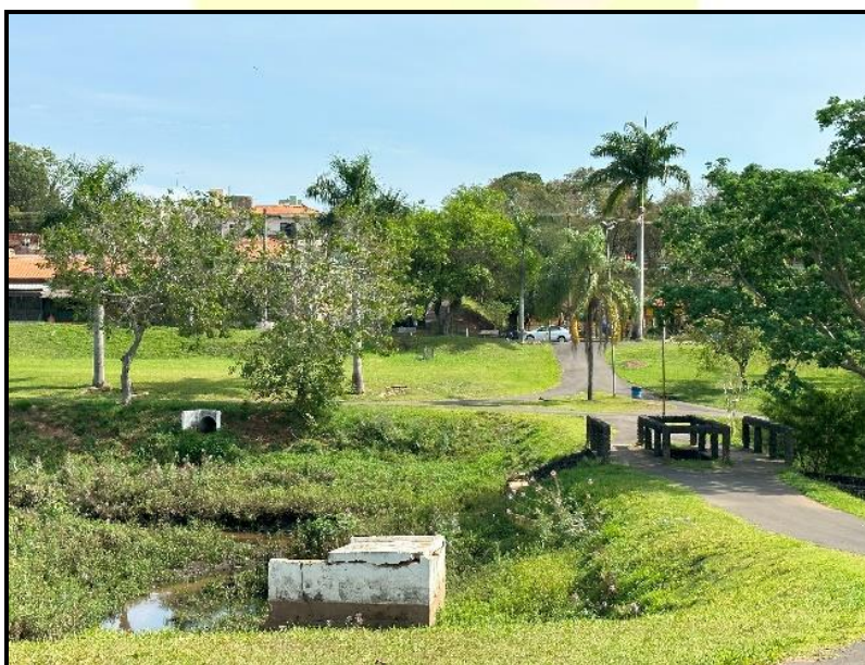
Figura 136 - Assoreamento no barramento do Córrego Lavapés
