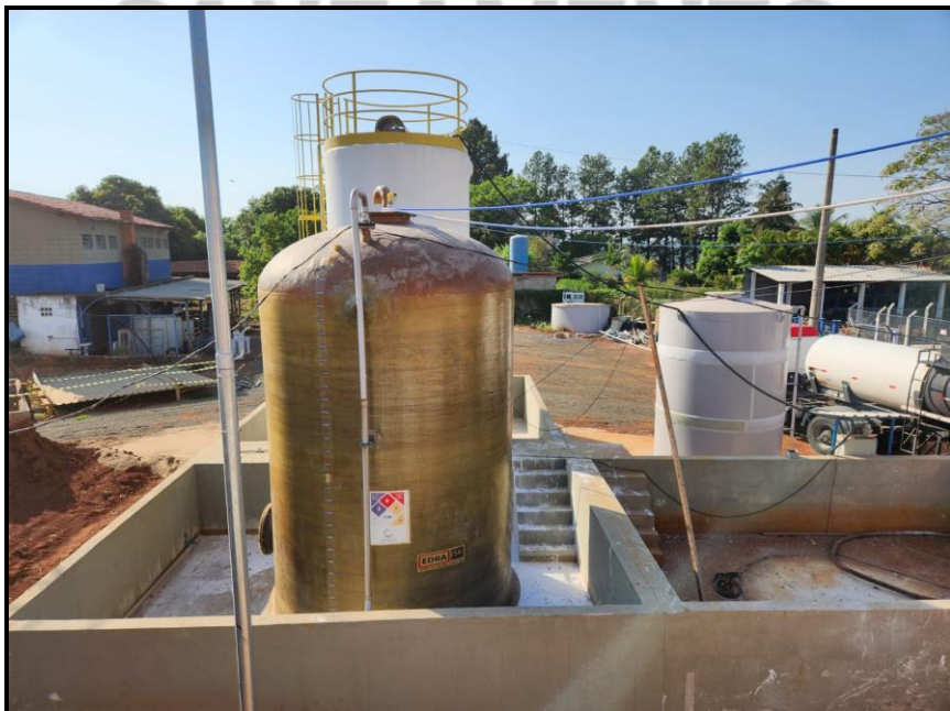
Figura 39 - Sistema armazenamento de produtos químicos
