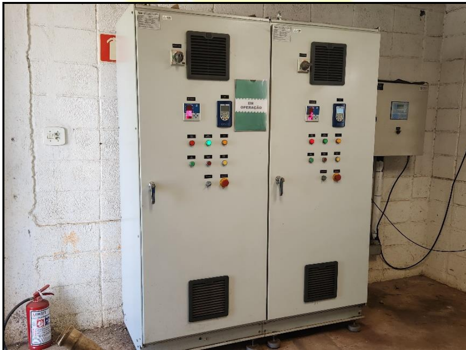
Figura 91 - Painel elétrico do Booster TG
