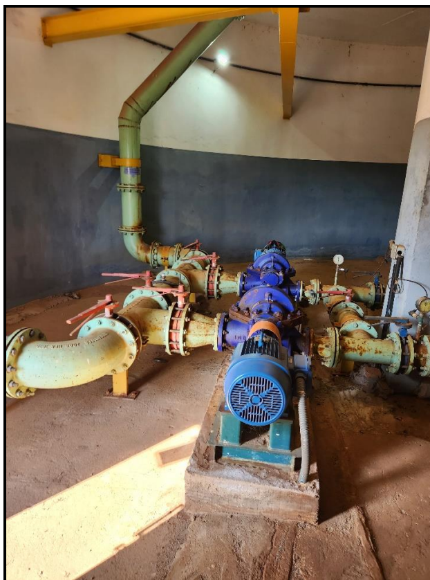
Figura 55 - Barrilete e conjuntos motor bomba
