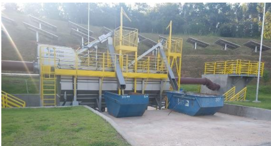
Foto 5: Tratamento Preliminar – ETE.
