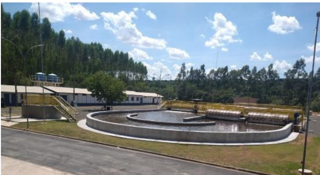
Foto 14: Caixa de Distribuição de Vazão e Reator Biológico 3 – ETE.
