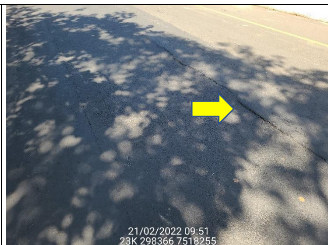
Fissura próximo ao numeral 760 da Av. Brasil
