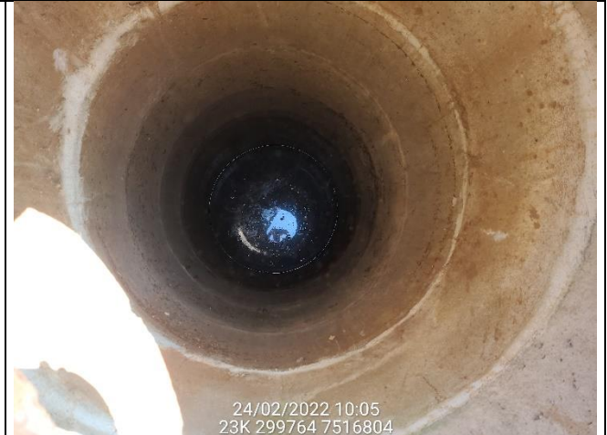
Interior do PV 34 – Totalmente inundado
