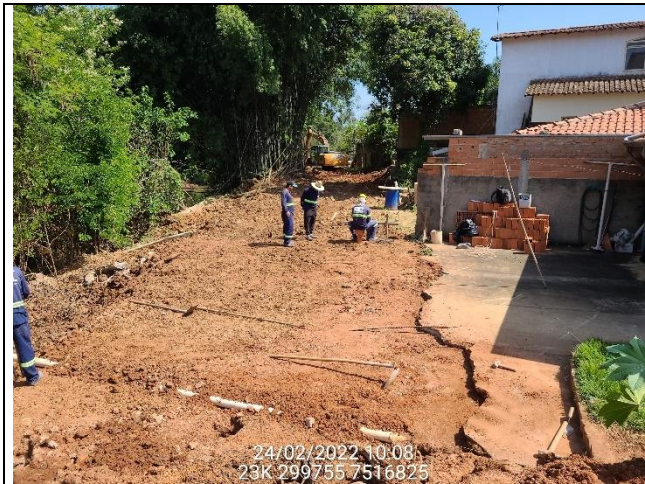
PV 34 – muro de fechamento não concluído
