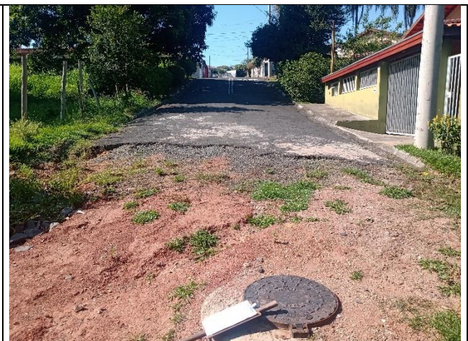
Necessidade de restituição do asfalto da via
