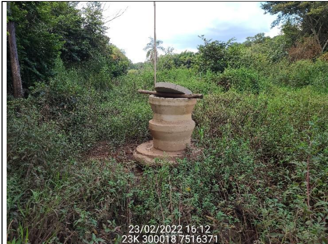
PV 39 sem condições de verificar o fechamento
