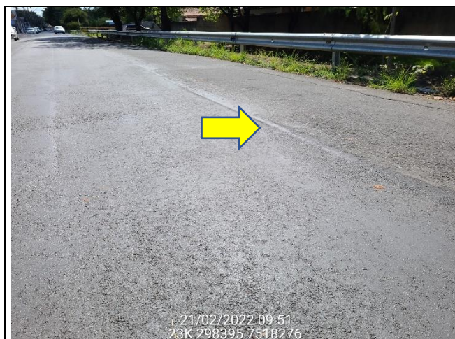
Recalque próximo ao numeral 706 da Av. Brasil
