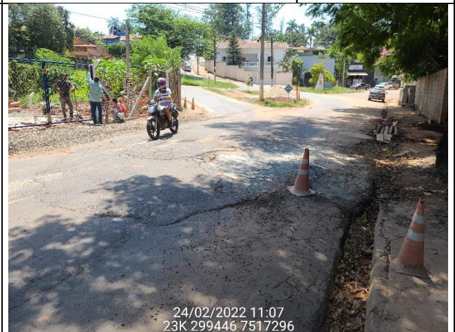
PV 25 – pavimento asfáltico deteriorado
