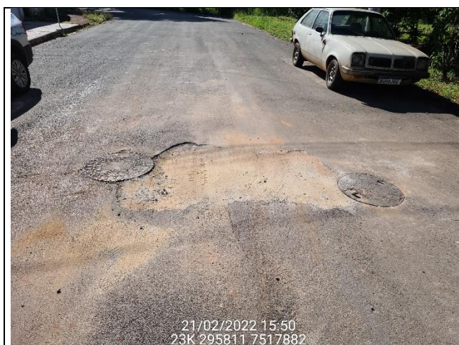
Falta de recape
