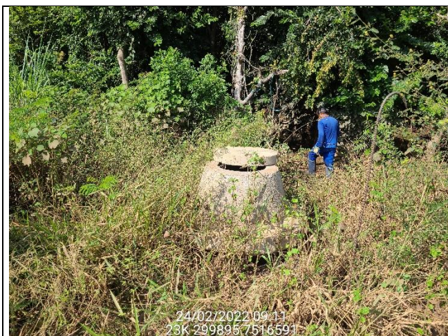
PV 36 em possível cota de inundação
