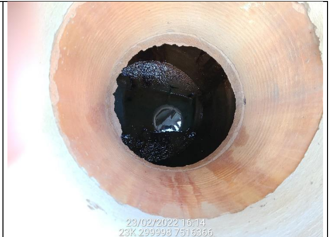
Interior do PV 39 – apresenta infiltração excessiva
