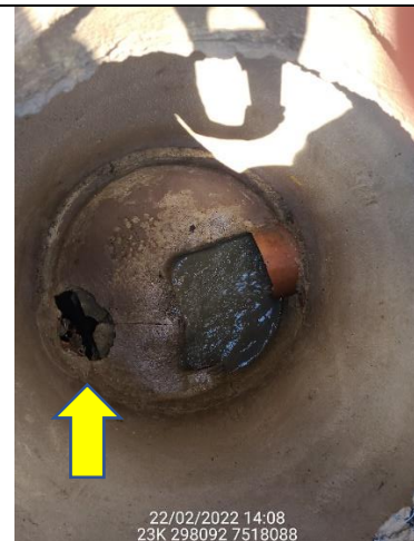
Fundo do PV 41 danificado
