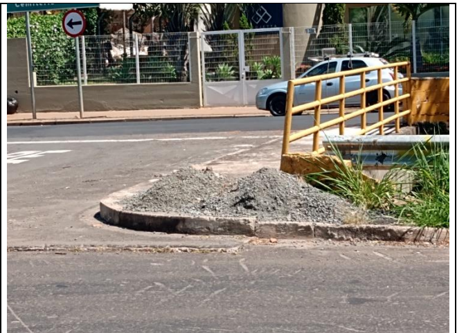
Disposição inadequada de agregado
