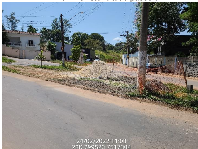
PV 25 – gramado do trevo deteriorado
