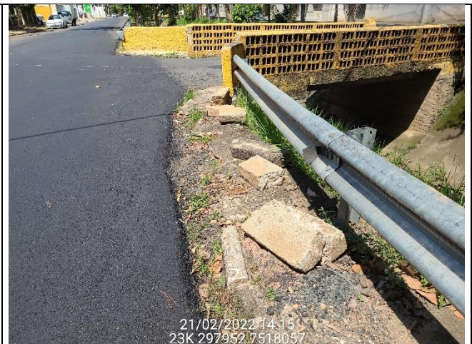
Guia deteriorada e solta
