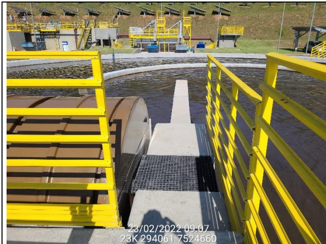
Ausência de Guarda Corpo
