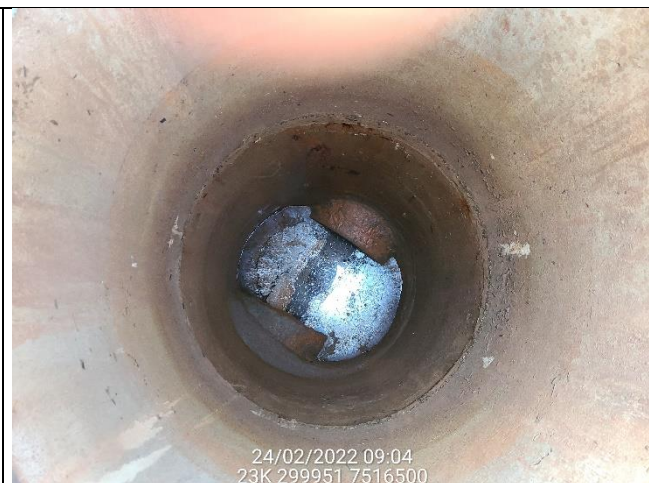
Interior do PV 37 – ¾ seção inundada por água
