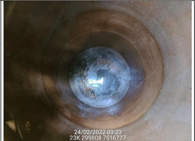
Interior do PV 34.1 – Totalmente inundado
