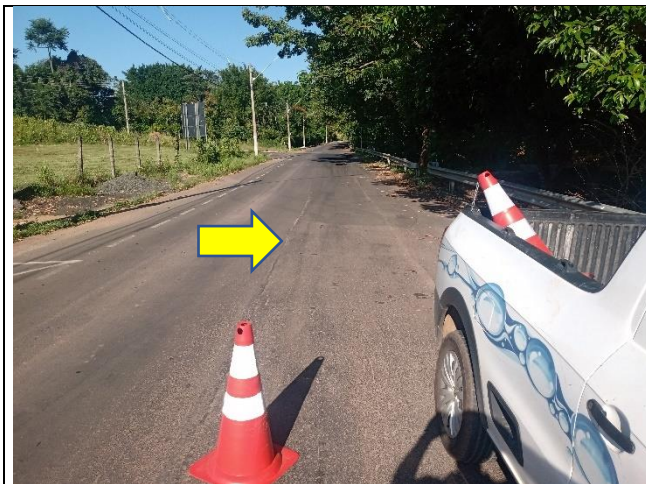
Recalque do pavimento
