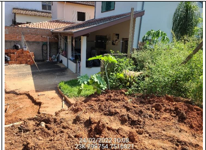
PV 34 – muro de fechamento não concluído
