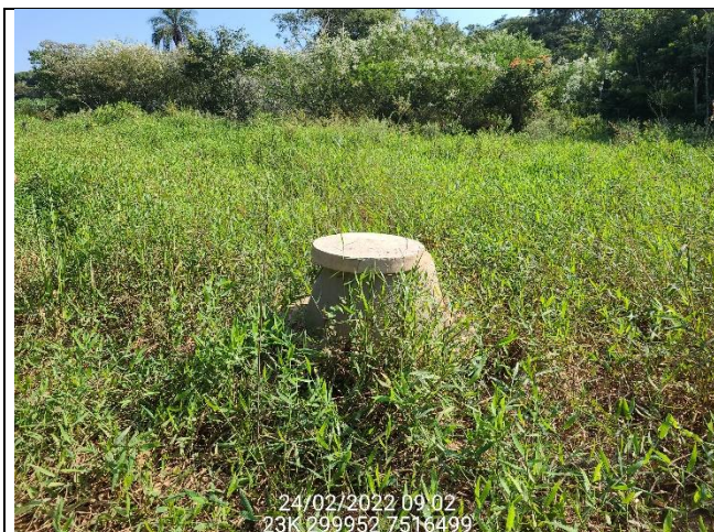
PV 37 em possível cota de inundação
