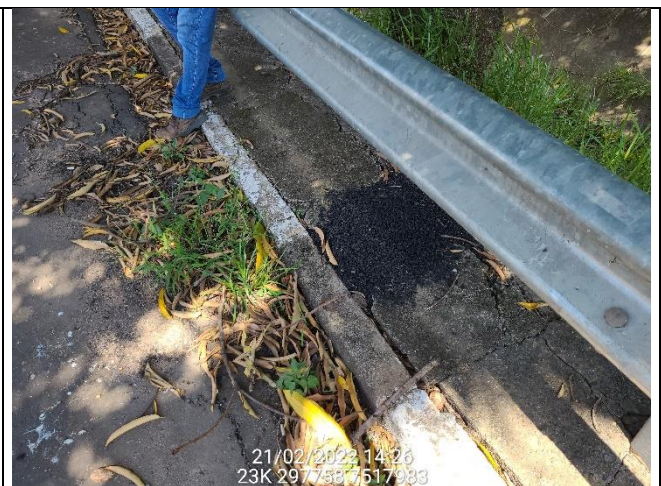
Disposição inadequada de cimento betuminoso
