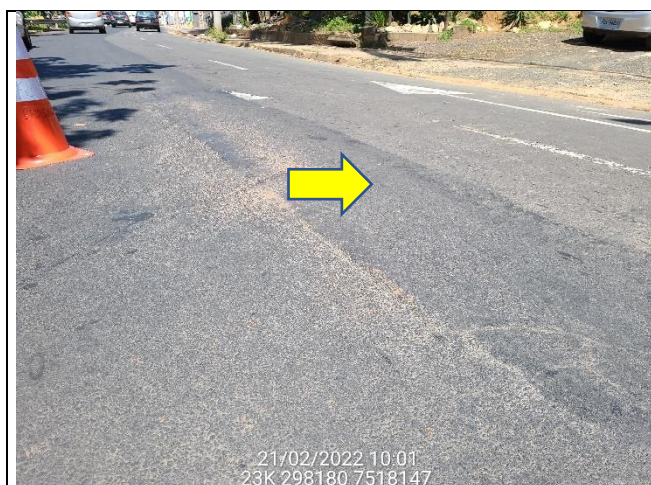
Recalque próximo ao numeral 980 da Av. Brasil
