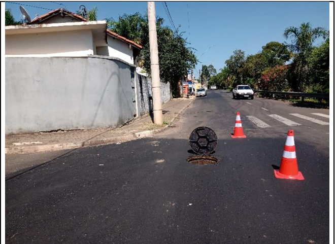
PV 46 - problema na borda (soltando)
