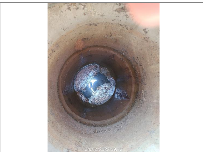
Interior do PV 36 – Totalmente inundado
