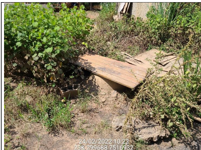
PV 32 – sem tampa
