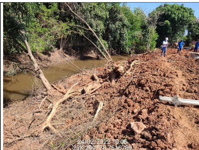
PV 34 – árvores inclinadas
