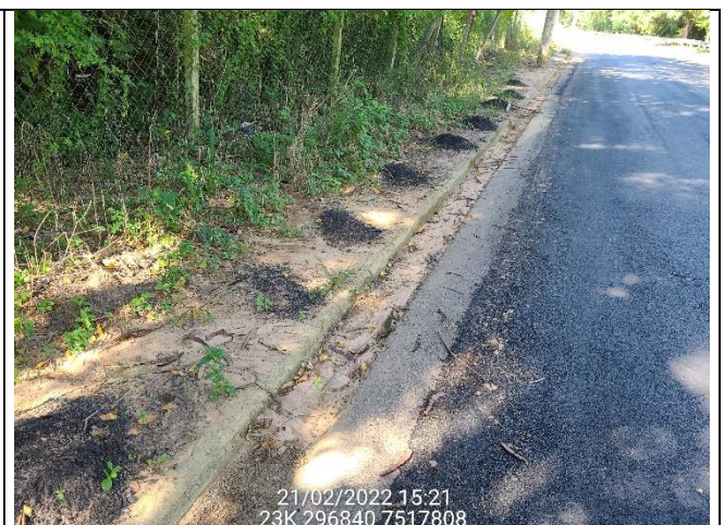
Disposição inadequada de cimento betuminoso
