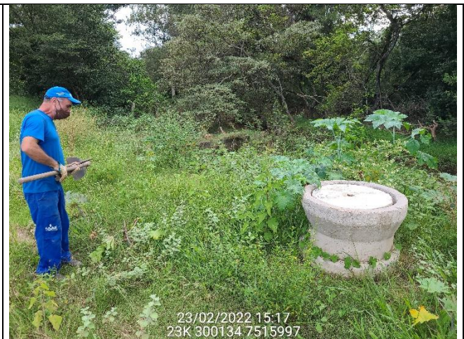
Pv inserido em cota de inundação
