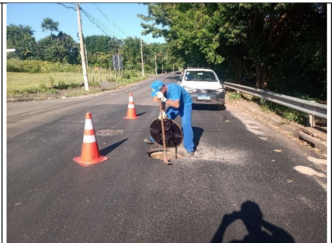
Desnível do PV 60
