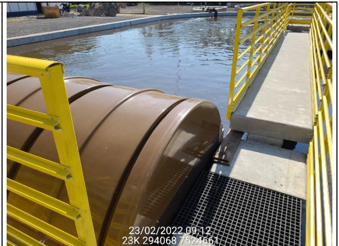
Ausência de Guarda Corpo
