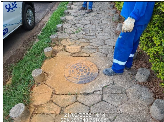
Poço de visita com sinal de transbordamento, devendo ser interligado ao Coletor tronco
