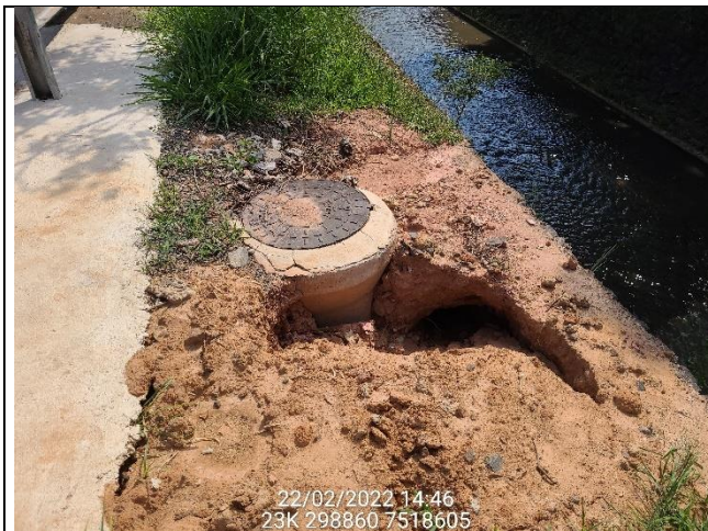
PV 3 com erosão e perímetro danificado
