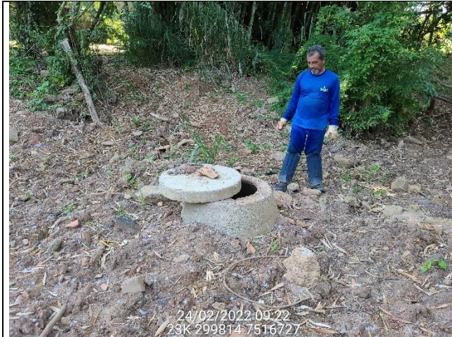
PV 34.1 em possível cota de inundação
