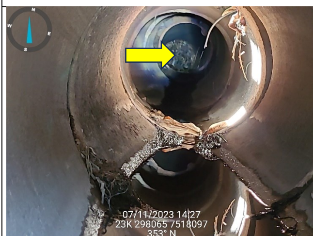
Detalhe da obstrução da GAP (seta amarela)
