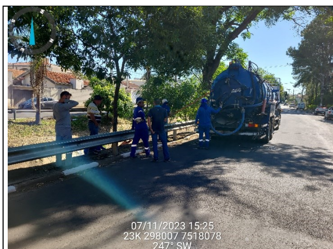
Região da GAP obstruída (proximidades do PV 19)
