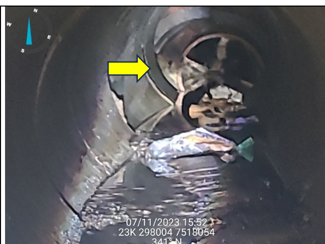
Rede desobstruída parcialmente
