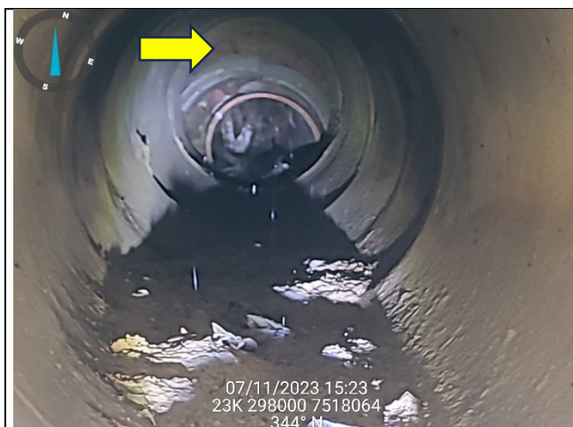
Colapso da rede na região da emenda (seta amarela)
