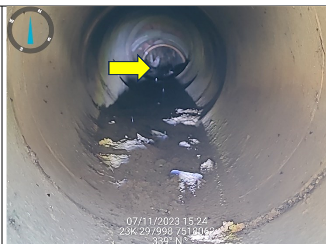
Detalhe da obstrução da GAP (seta amarela)
