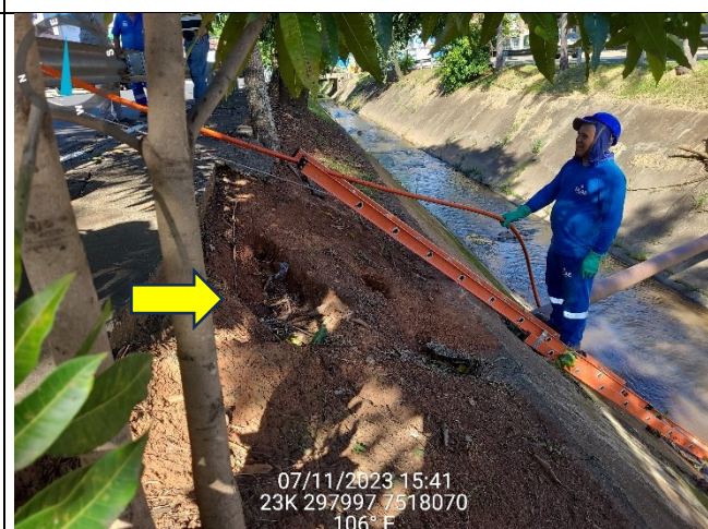
Afundamento no talude nas proximidades do desague da GAP (seta amarela)
