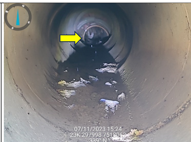
Detalhe da emenda do tubo em PVC Ocre, não havendo concordância entre as geratrizes dos tubos em concreto ocre (seta amarela)
