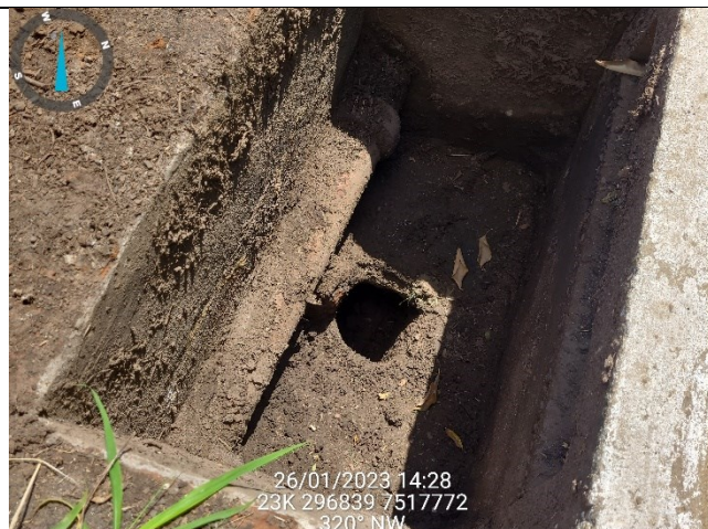
Boca de lobo com a tubulação totalmente obstruída
