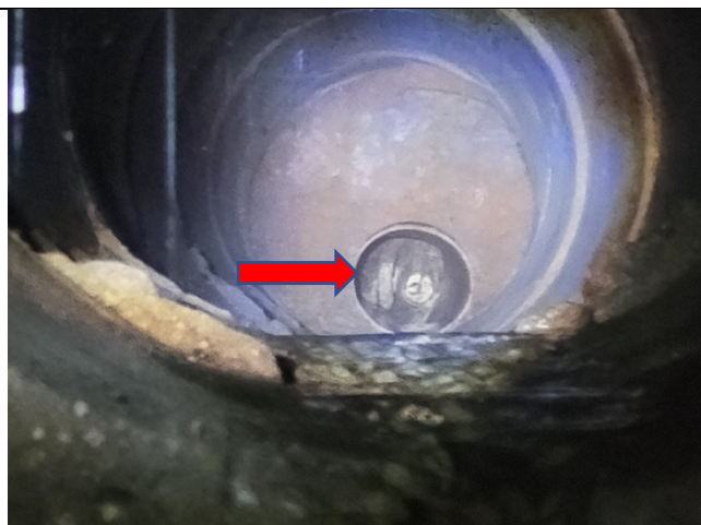
Estrangulamento da seção da Galeria de Águas Pluviais
