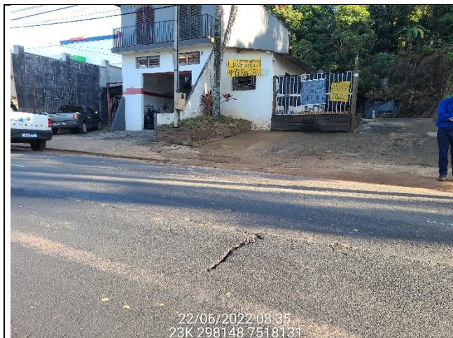
Deslocamento do pavimento
