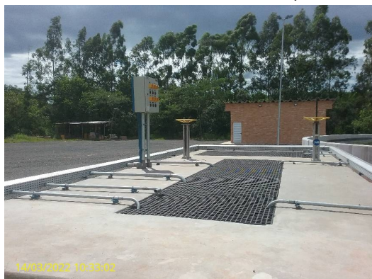
Foto 12 - Elevatória de retorno de lodo
