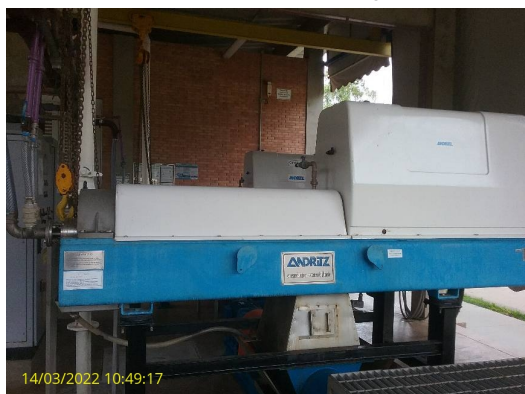
Foto 24 - Centrífugas de lodo
