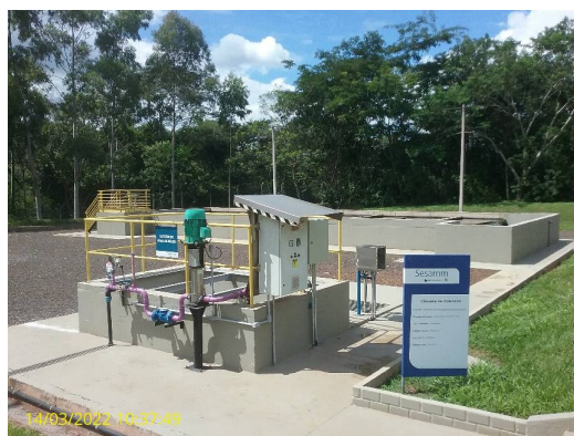
Foto 15 - Estação de reúso de água
