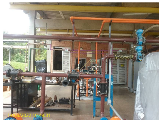
Foto 25 - Unidade de tratamento de lodo
