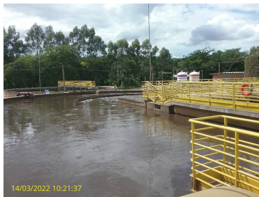
Foto 8 - Reator de aeração - R1
