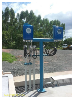
Foto 13 - Medidores de vazão de lodo
