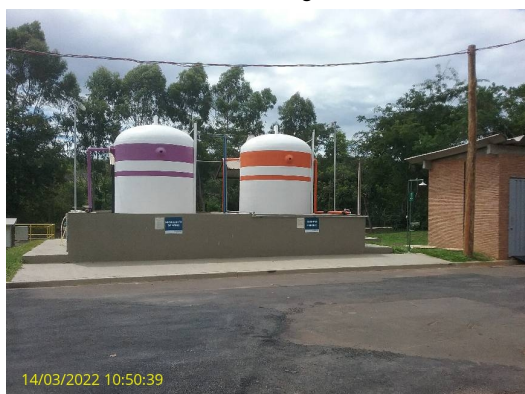
Foto 26 - Armazenamento de produto químico
