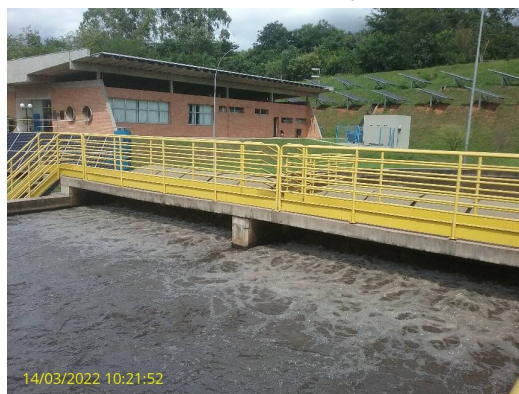
Foto 9 - Reator de aeração - R2
