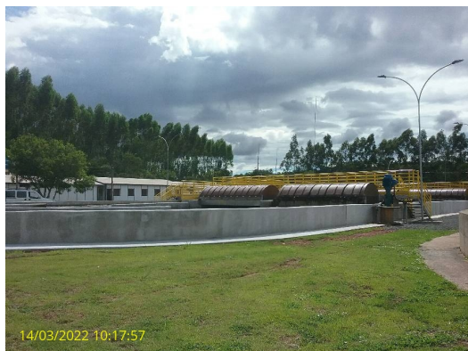
Foto 7 - Tem um equipamento em manutenção. Usando só um lado
