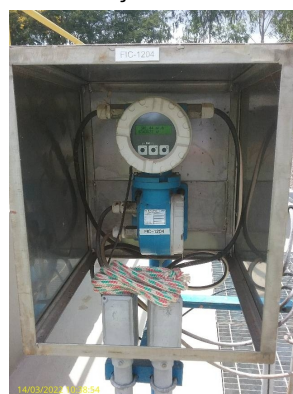
Foto 17 - Medidor de vazão lançamento final
