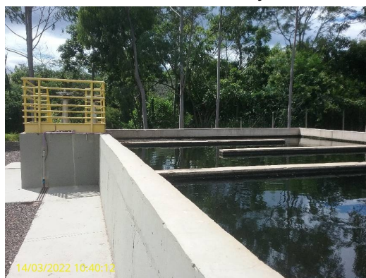
Foto 19 - Tanque de contato
