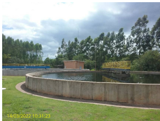
Foto 11 - Decantadores 2ª etapa
