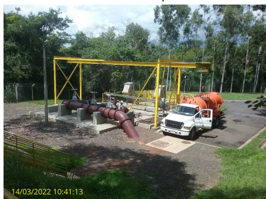
Foto 20 - Estação Elevatória de Esgoto
