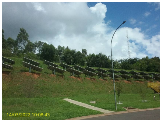
Foto 1 - Vista geral da Usina de energia fotovoltaica
