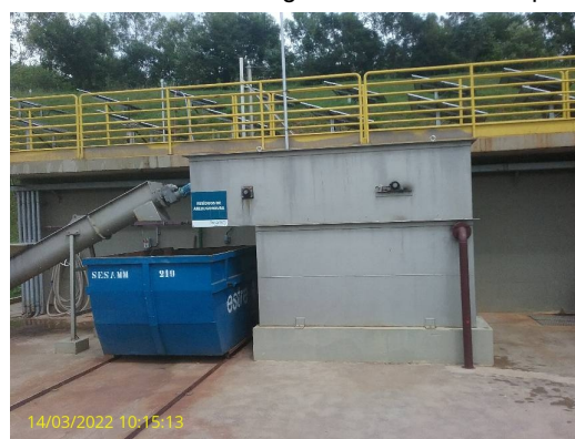
Foto 6 - Caçamba de sólidos
