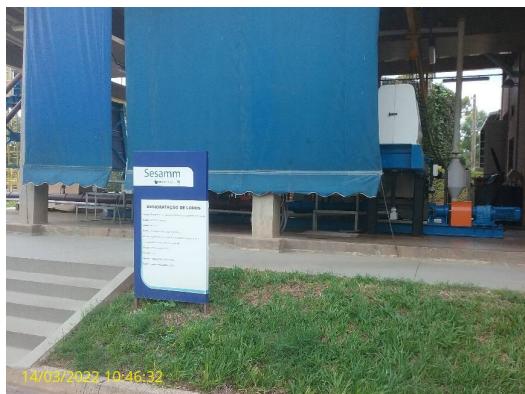
Foto 22 - Unidade de desidratação de lodo
