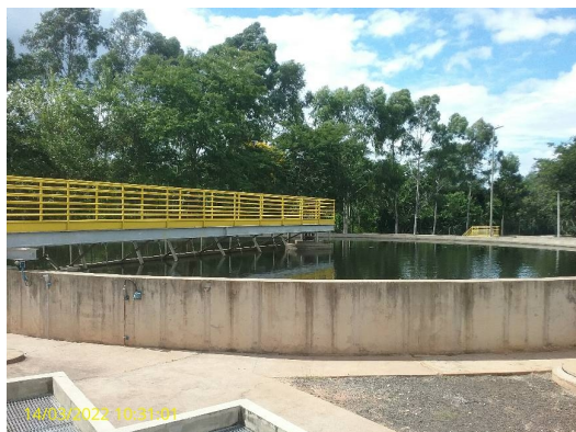
Foto 10 - Decantadores 3ª etapa
