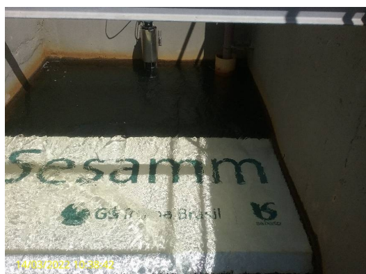
Foto 16 - Saída de água de reúso
