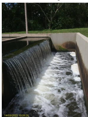
Foto 18 - Saída do Tanque de contato
