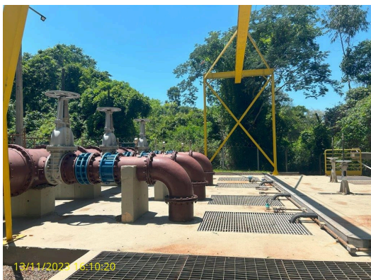
Foto 43 - Barrilete da EEEB
