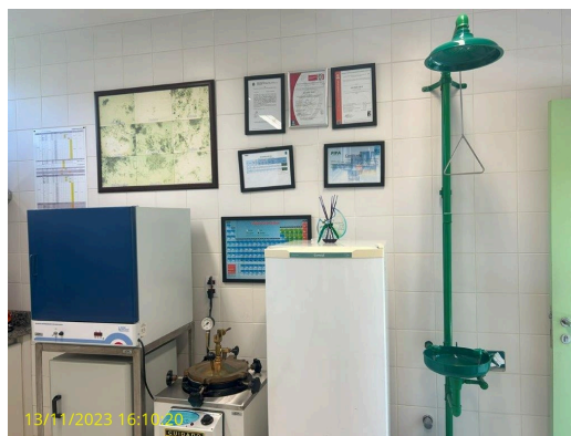
Foto 2 - Chuveiro de emergência
