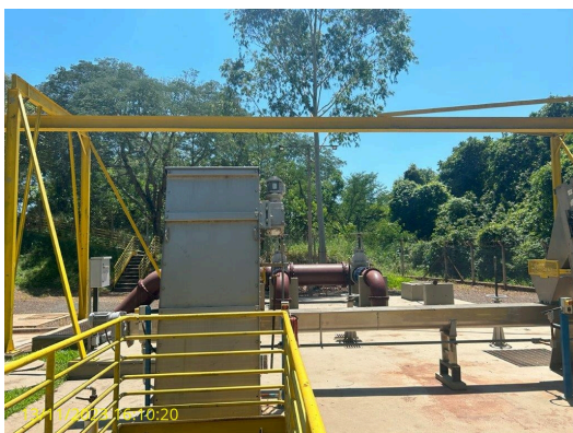
Foto 45 - Estação elevatória de esgoto bruto
