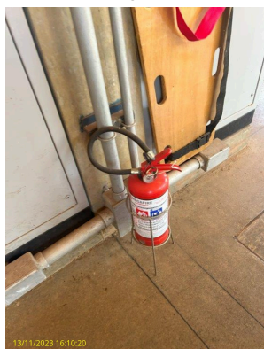
Foto 37 - extintor de incêndio
