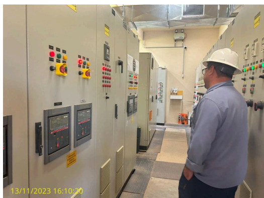
Foto 39 - Sala de painéis da ETE
