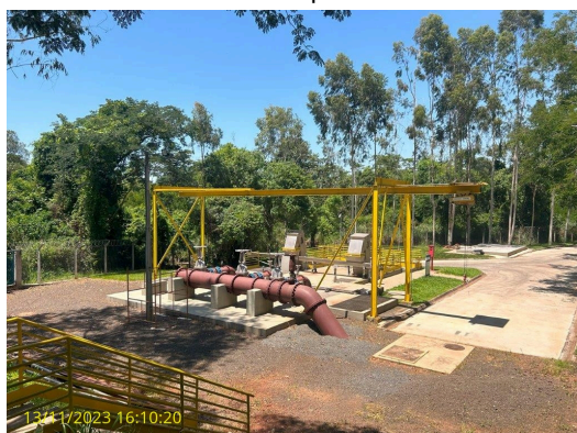
Foto 41 - Estação elevatória de esgoto bruto
