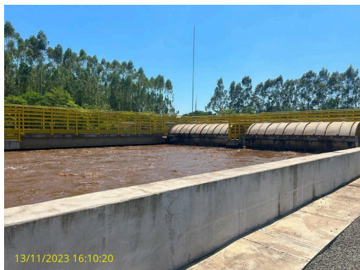
Foto 19 - Vista dos reatores de aeração
