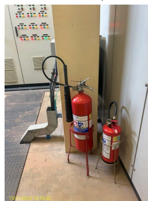
Foto 40 - Extinto de incêndio
