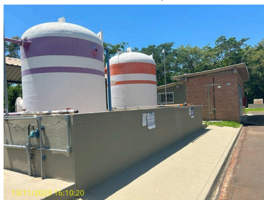
Foto 32 - Armazenamento de hipoclorito e cloreto ferrico
