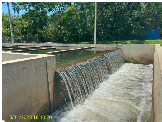
Foto 30 - Saída do tanque de contato
