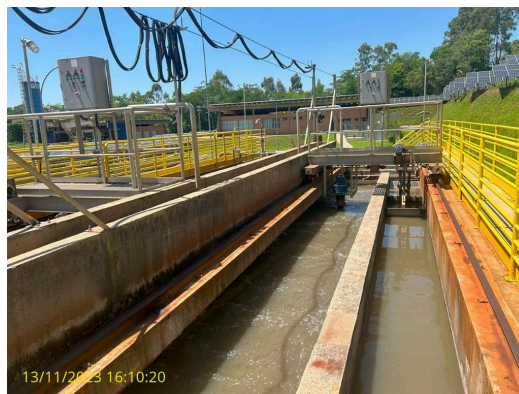
Foto 12 - Unidade de desarenação
