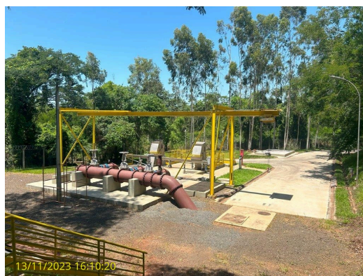
Foto 42 - Estação elevatória de esgoto bruto
