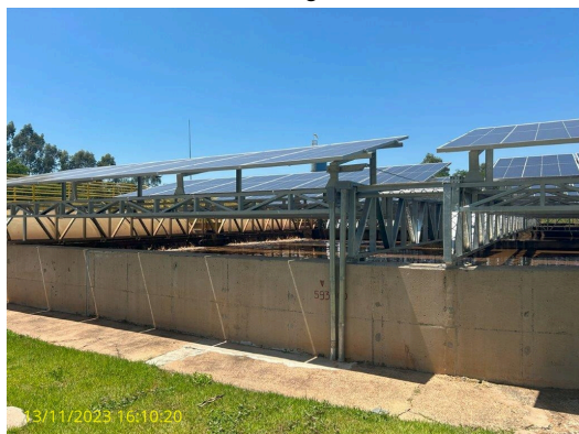
Foto 17 - Vista dos reatores de aeração
