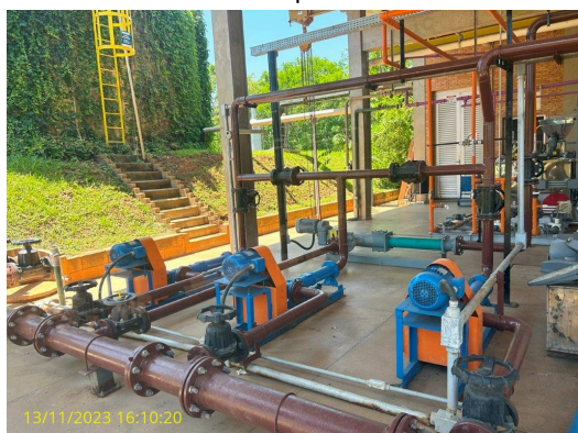
Foto 33 - Bombas de polímero
