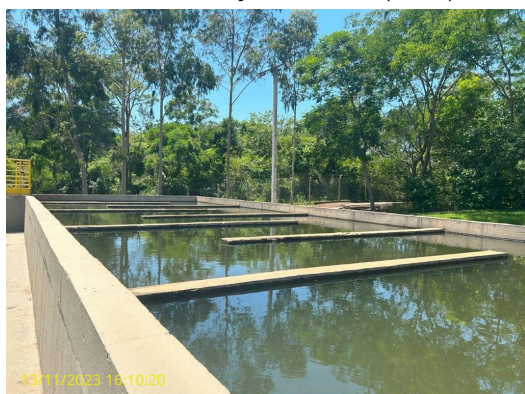
Foto 31 - Tanque de contato
