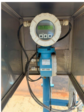
Foto 3 - medidor de vazão
