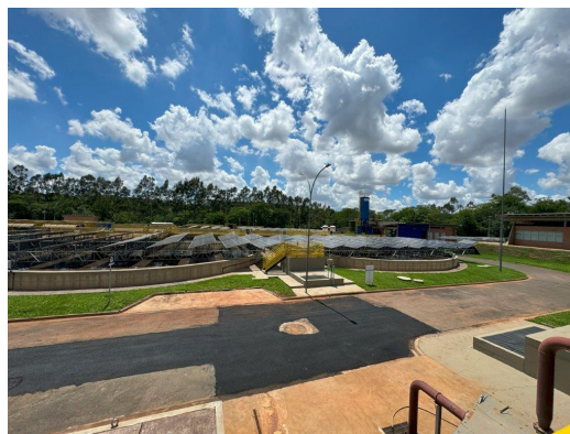
Foto 6 - Vista dos reatores
