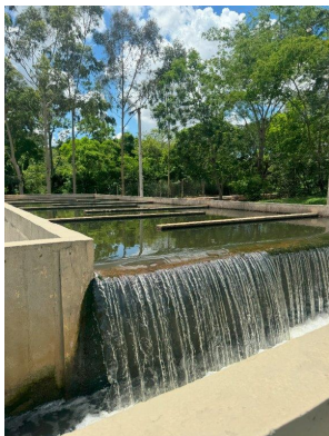
Foto 13 - Tanque de contato
