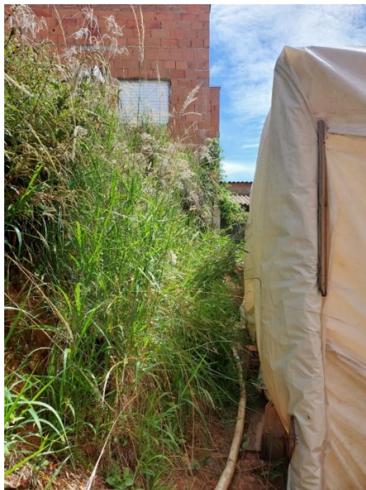
Figura 4-56. detalhe da tubulação de esgoto aparente
