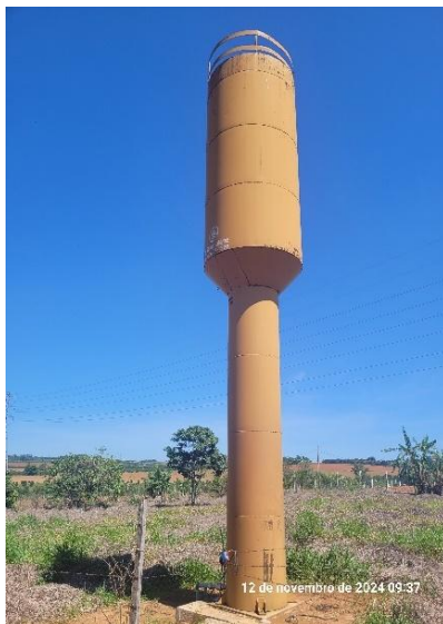
Figura 4-109. Núcleo II – Reservatório de água potável abastecido por poço artesiano
