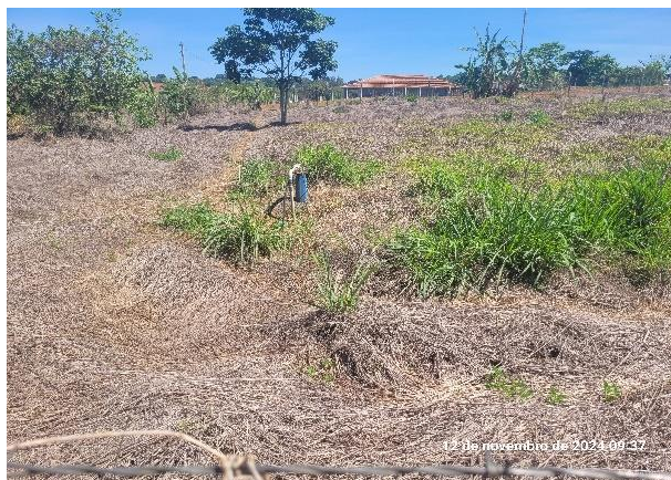
Figura 4-110. Núcleo II – Localização do poço artesiano que abastece o núcleo
